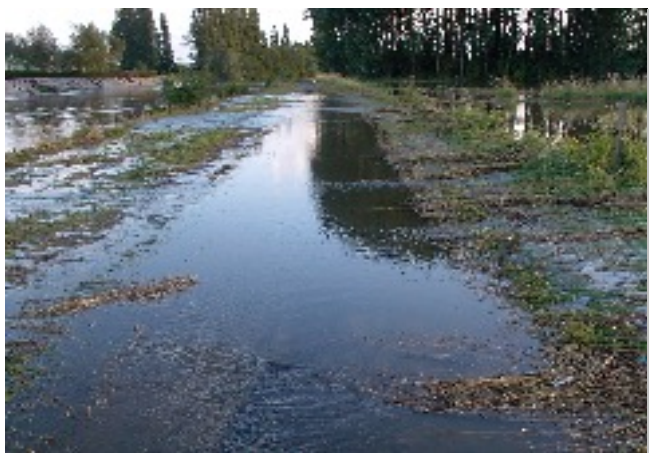
Inondation du chemin de halage entre la station d'épuration et la peupleraie.
